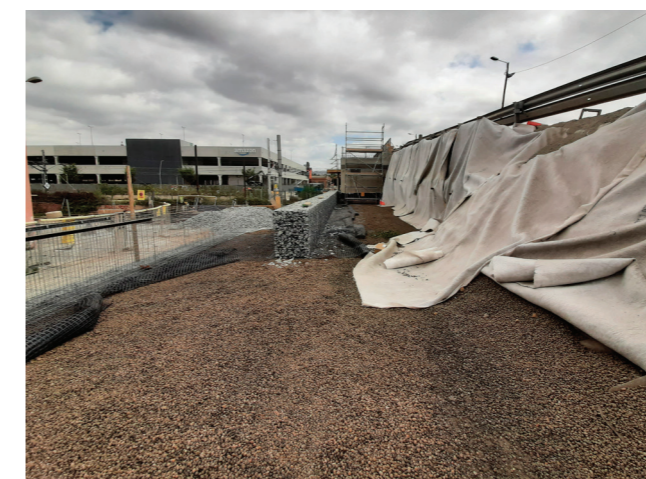
Instalacja Leca® KERAMZYTU z wykorzystaniem geokraty w przestrzeni ścian oporowych z gabionów containment.
