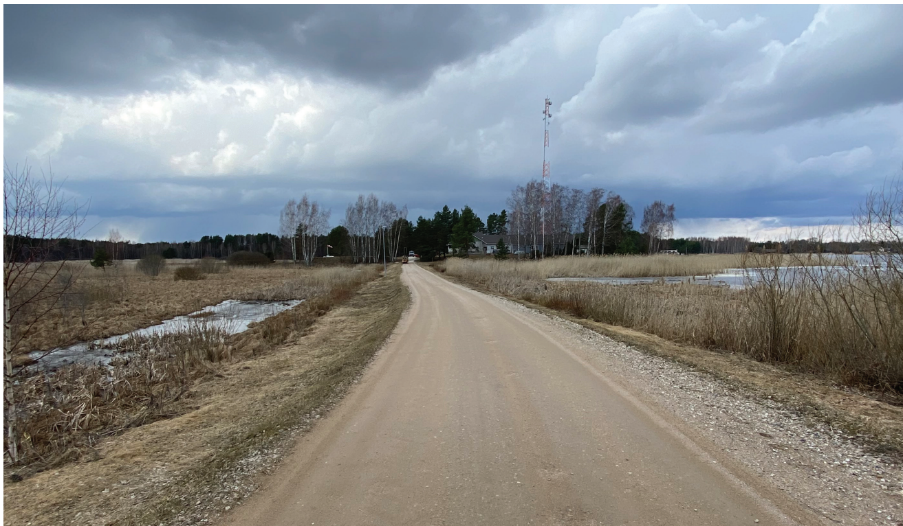
160-metrowy odcinek drogi prowadzący do posterunku Straży Granicznej Estonii jest nadal w doskonałym stanie po ponad 24 latach użytkowania.
