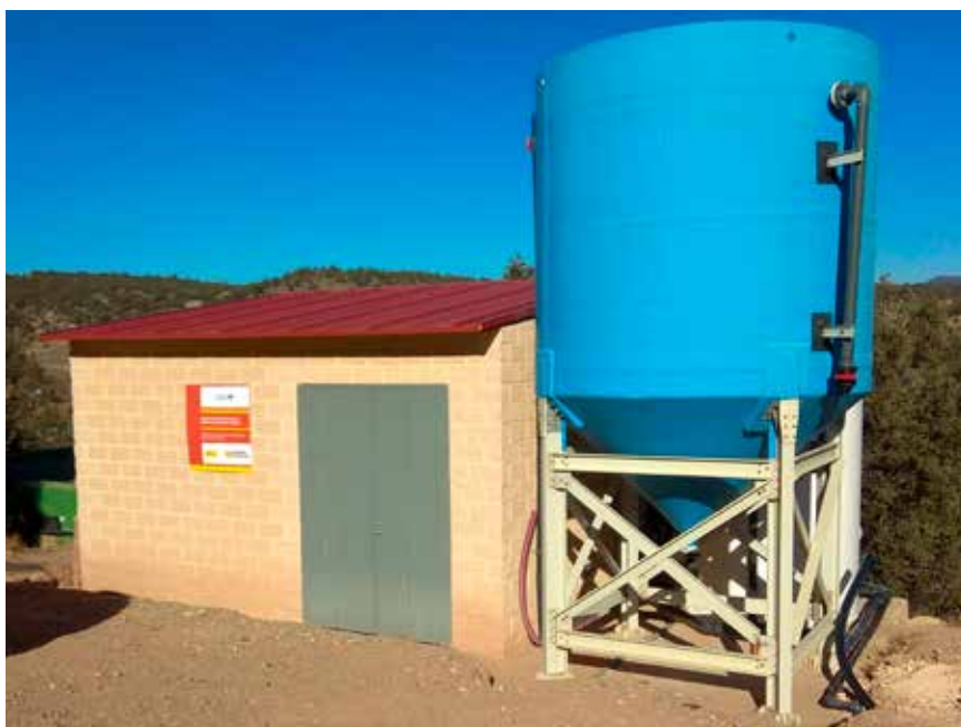
Widok niewielkiej stacji z osadnikiem umieszczonym na zewnątrz.
